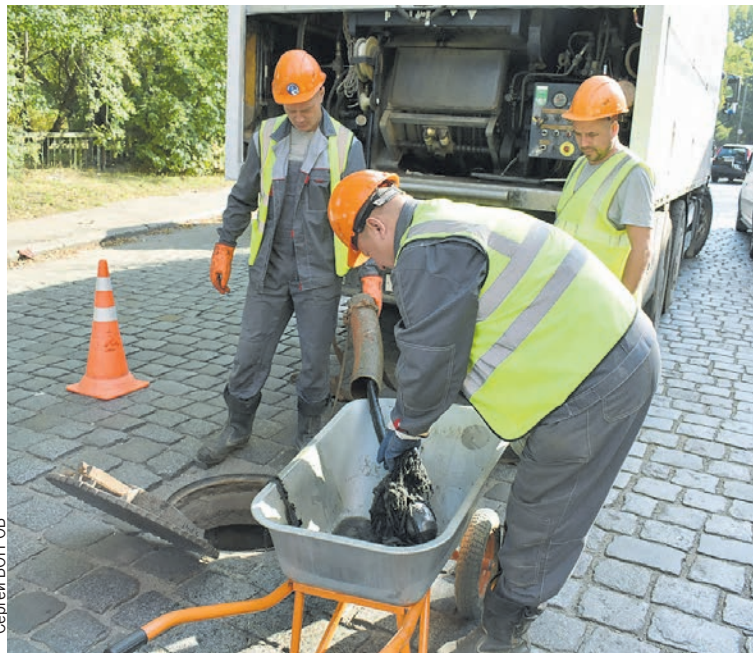
Власти держат на особом контроле вопрос замены труб тепло-, водоснабжения и водоотведения.
